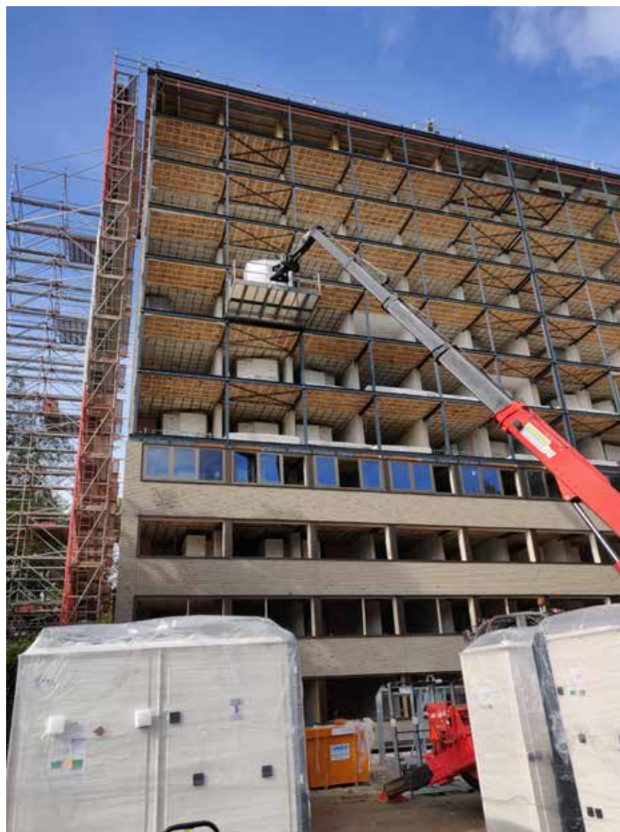
"Voor de plaatsing van de S-pod ® badkamers hebben we gebruikgemaakt van verreikers met een bereik van wel 30 meter hoogte."
