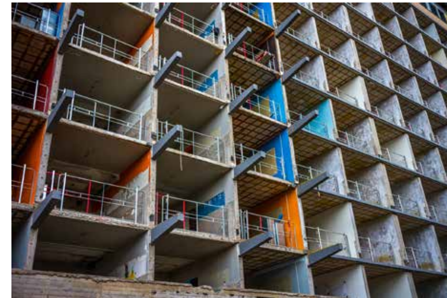
De uitbreiding moest volledig in een staalconstructie worden uitgevoerd, met stijve koppelingen van gevels en vloeren.
